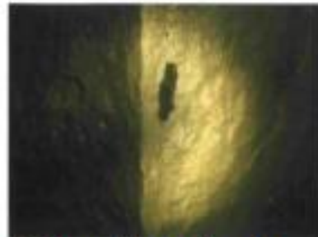
Microbiologisch geïnduceerde corrosie (MIC)
